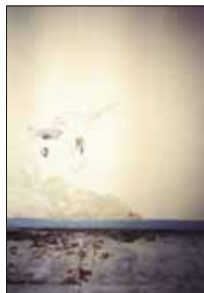
Starke Wandausblühungen durch jahrelange Bodenfeuchtigkeit aufgrund unmerkter Heizungsleckage
