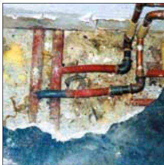
Exakte Ortung einer Leckage im Heizungssystem
