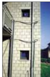
Trocknung eines doppelschaligen Mauerwerks
